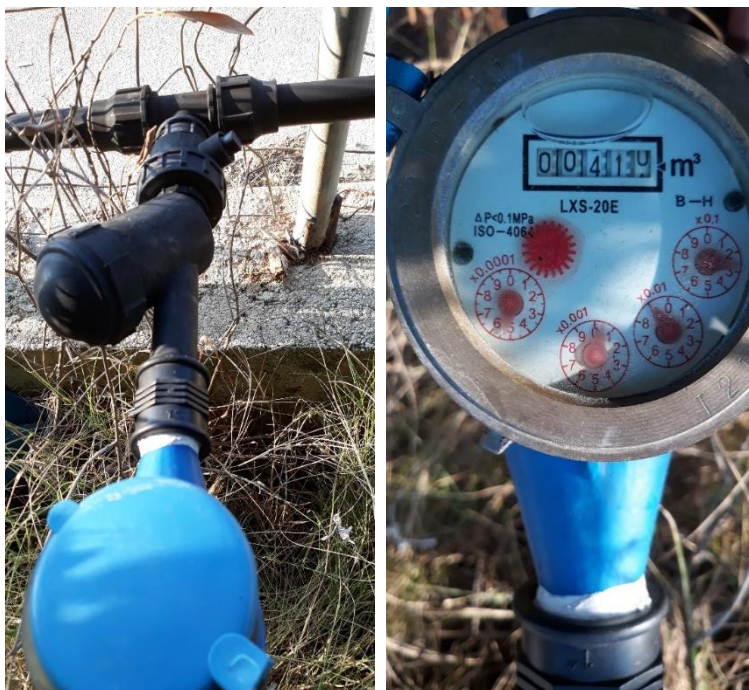
Εικόνα 12 Εγκατεστημένο υδρόμετρο 1' στη δευτερεύουσα γραμμή άρδευσης στον ελαιώνα
