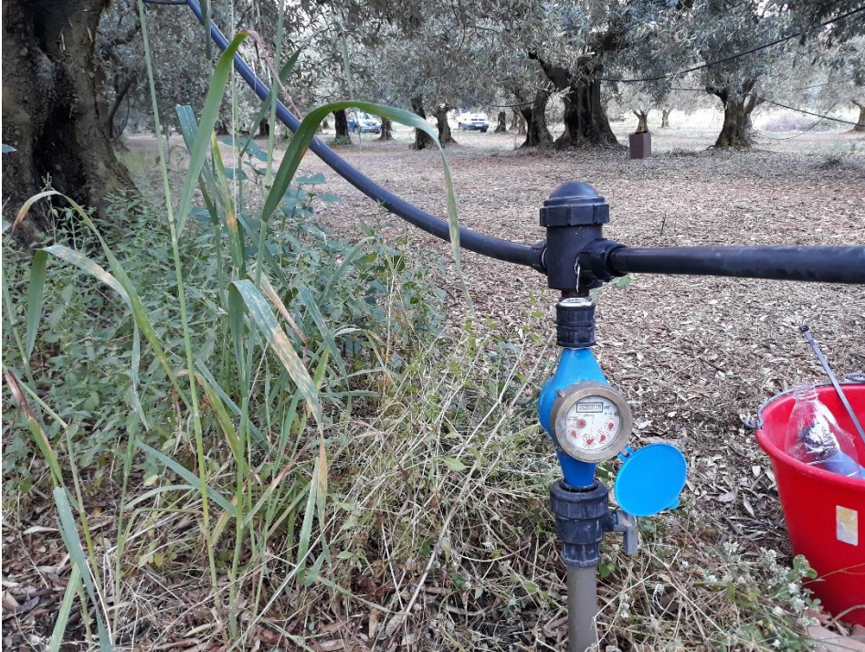
Εικόνα 10 Υδρόμετρο εγκατεστημένο στη δευτερεύουσα γραμμή άρδευσης του πιλοτικού αγροτεμαχίου
