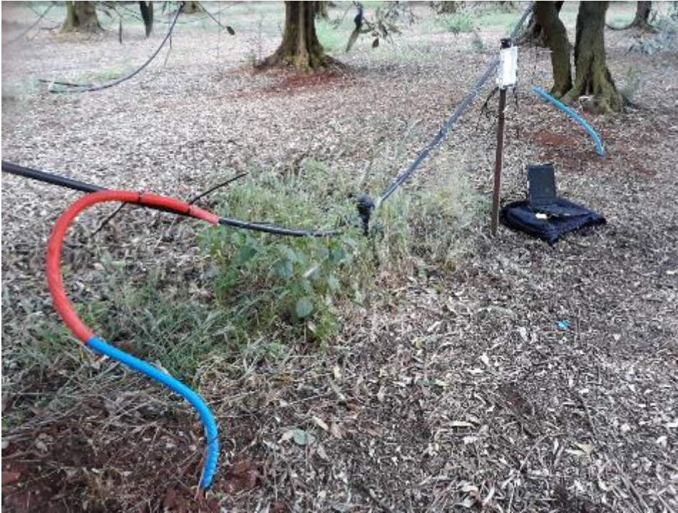
Εικόνα 8 Εγκατεστημένοι αισθητήρες υγρασίας εδάφους τοποθετημένοι σε πιλοτικό αγροτεμάχιο μαζί με το καταγραφικό δεδομένων. Τα καλώδια των αισθητήρων έχουν καλυφθεί με πλαστικό σωλήνα για προστασία.
